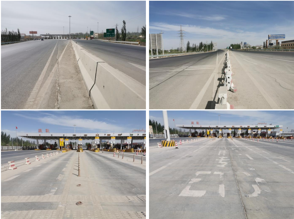
收费站前面标线模糊，标线混乱
