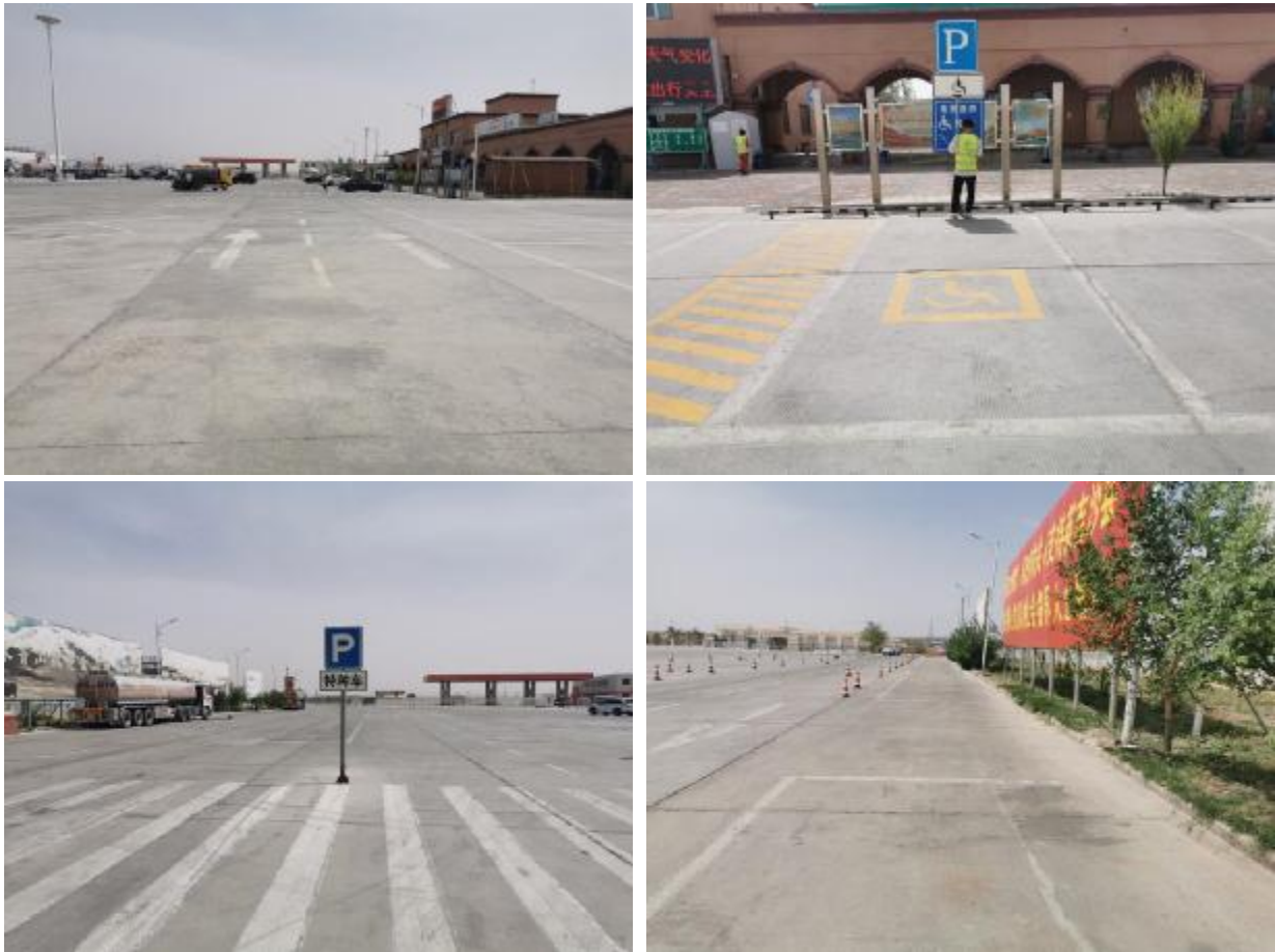
收费站前面标线模糊，标线混乱
