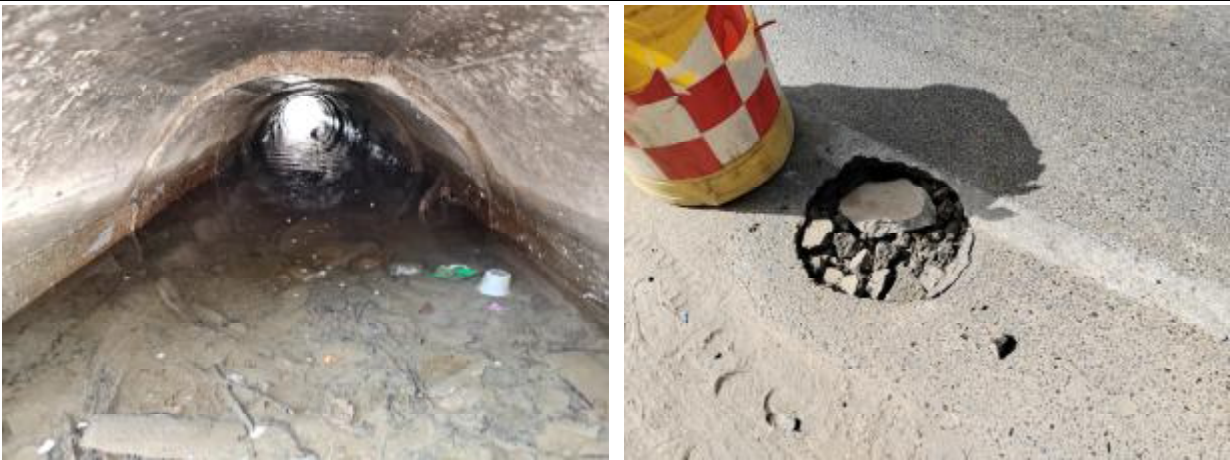
涵洞病害照片
