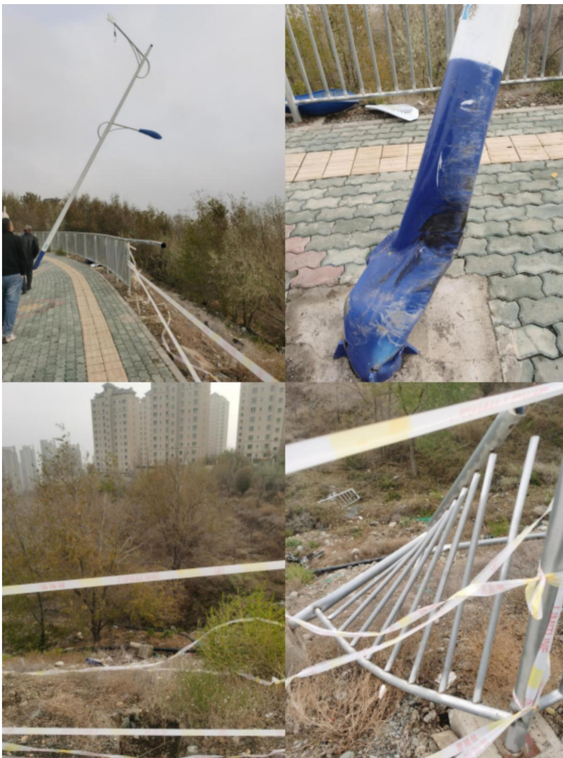
乌鲁木齐市沙依巴克区高山路路灯及护栏损坏现场图片
