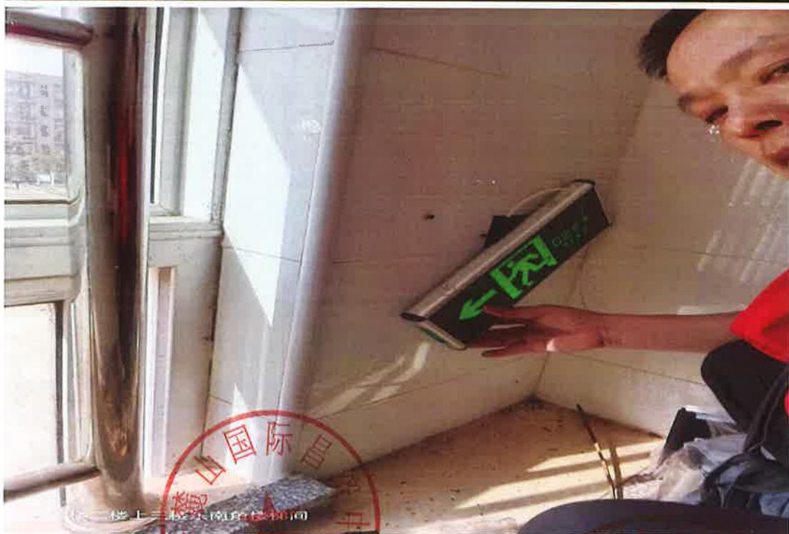
翔行楼五楼西楼梯应急灯
