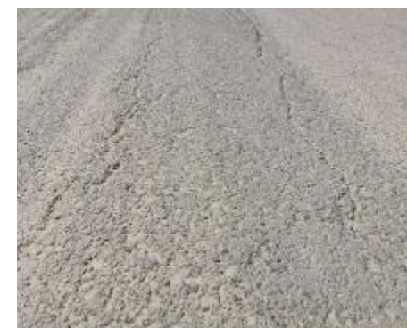
图 3 路面磨损较大、不规则裂缝
