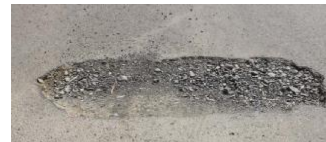
图 4 少数路段小坑槽
