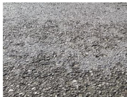
图 1 路面磨损较大 骨料露出
