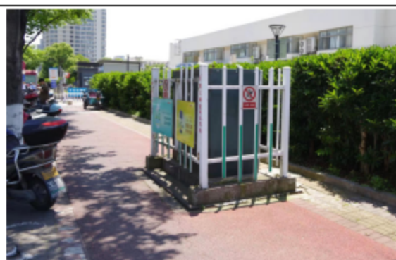
人行道被电箱侵占
