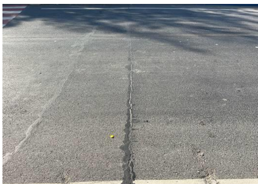
图 1-1-3 桥面连续处横向开裂
