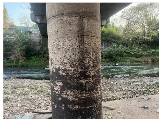
图 1-1-7 立柱刮擦漏筋
