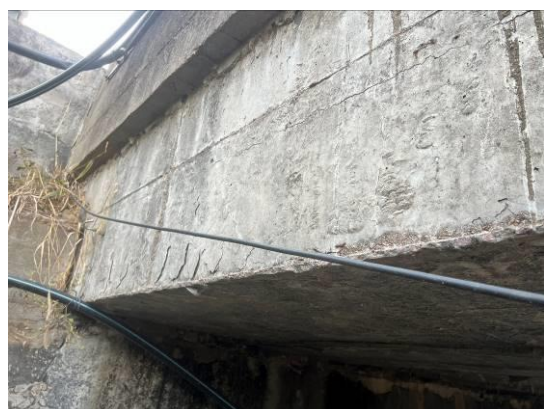
图 1-1-5 腹板锈胀漏筋
