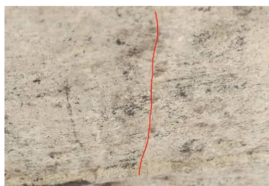
图 1-1-4 梁板横向裂缝
