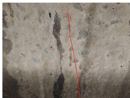
图 1-1-5 盖梁竖向裂缝
