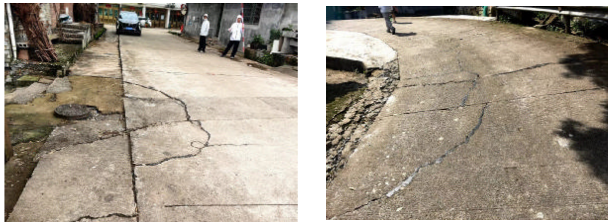
图3.1-3 板角断裂病害
