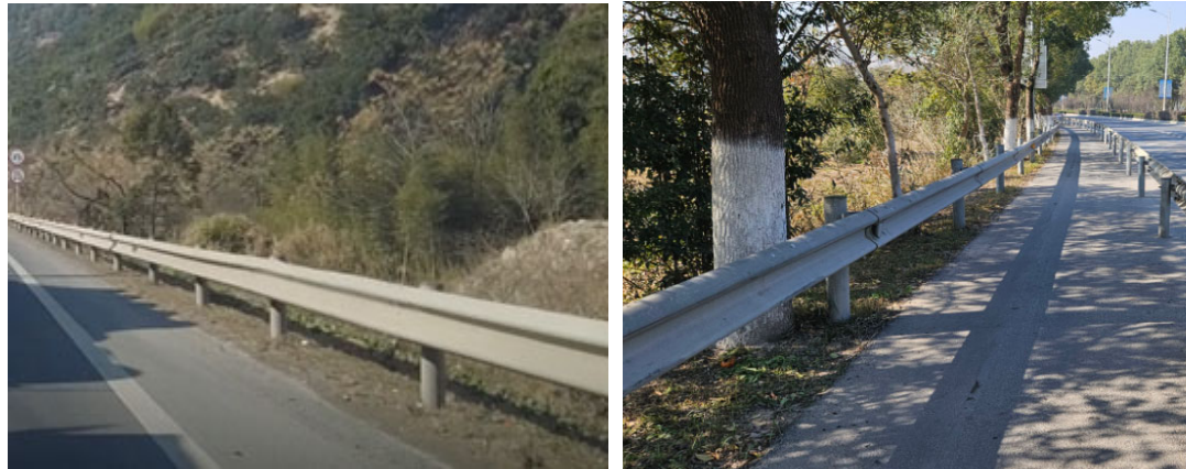
4、原雷双线已提升为 207 省道，部分路段路侧需增设护栏提高防护等级。
