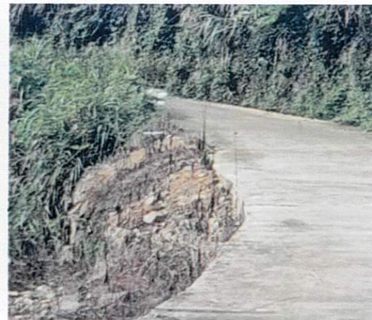
C线压顶缺失
