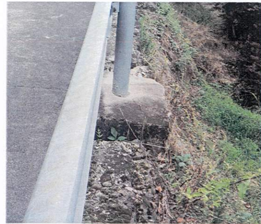
B线压顶损坏
