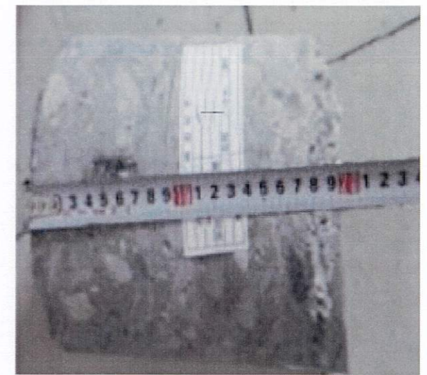
C线水泥路面芯样
