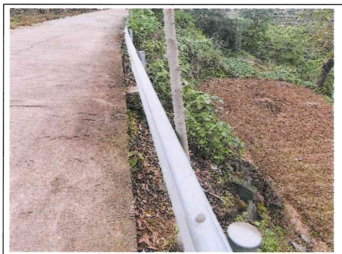
原有挡墙倒塌照片
