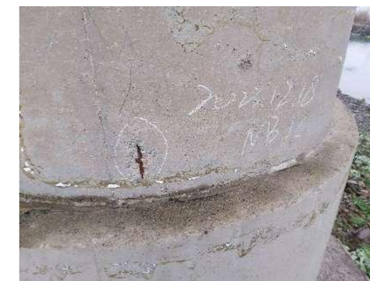
图 18 桥墩砼破损露筋
