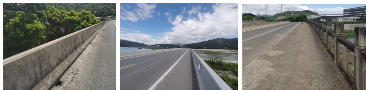
图 24 杜岙、白溪、力洋大桥护栏现状
