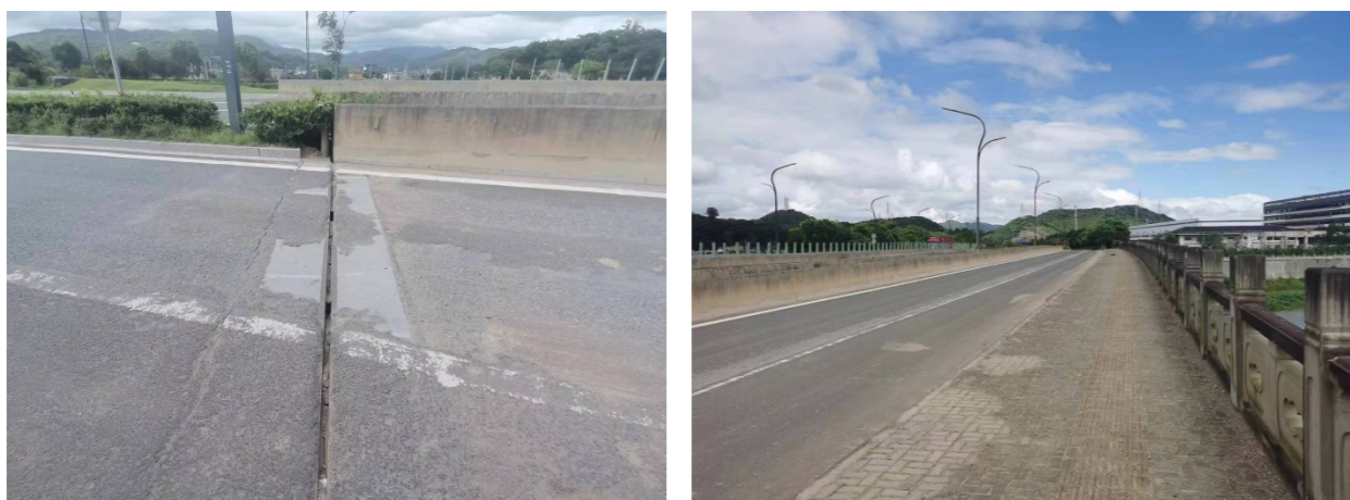
图 34 力洋大桥路面病害情况
