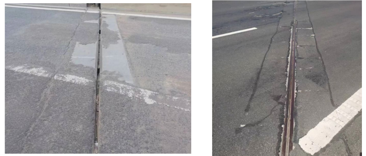
图 31 伸缩缝堵塞、锚固区砼破损
