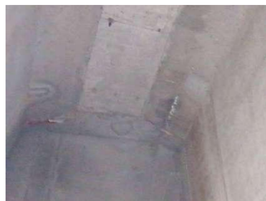
图 30 小箱梁翼缘板纵向裂缝析白
