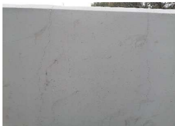
图 35 白溪大桥护栏涂装开裂
