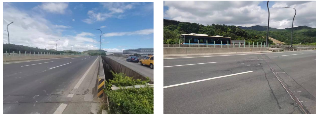
图 23 桥面铺装坑槽、网裂
