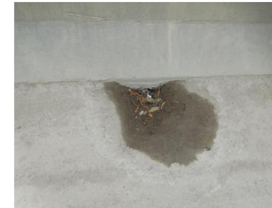
图 20 桥面排水孔堵塞
