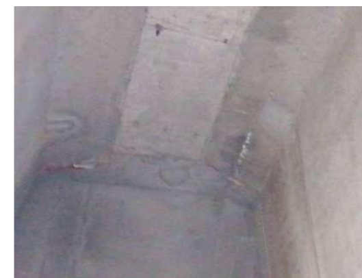
图 17 小箱梁翼缘板纵向裂缝析白
