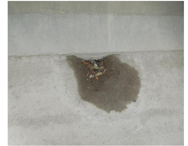
图 66 力洋大桥桥面排水孔堵塞
