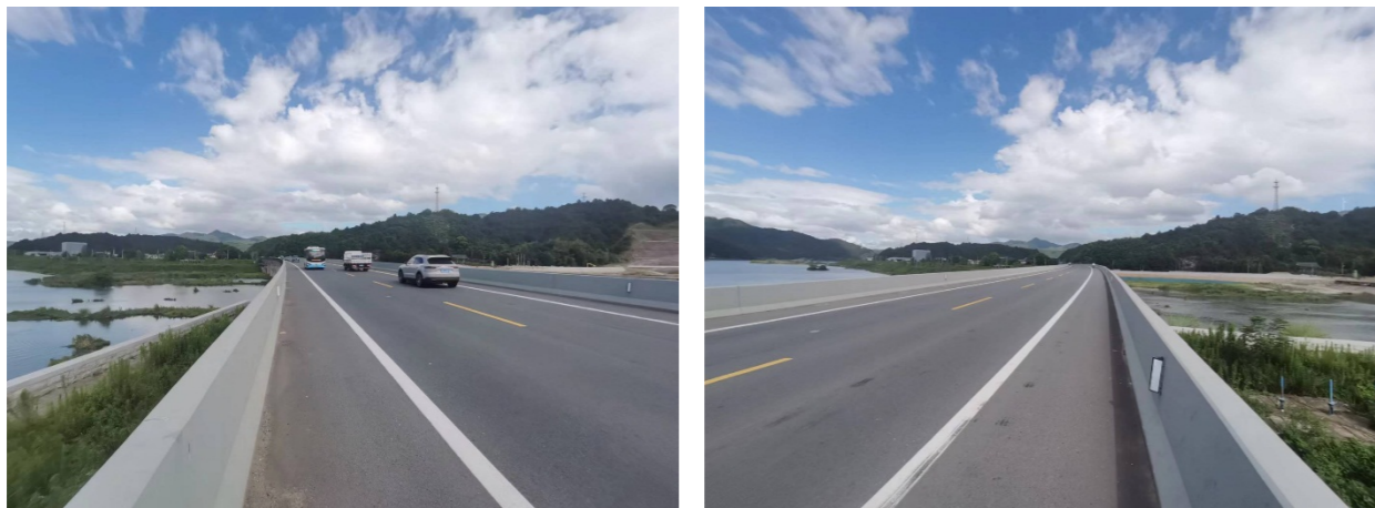
图 32 白溪大桥路面病害情况
