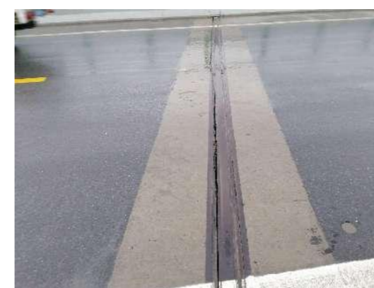
图 19 伸缩缝橡胶条破损
