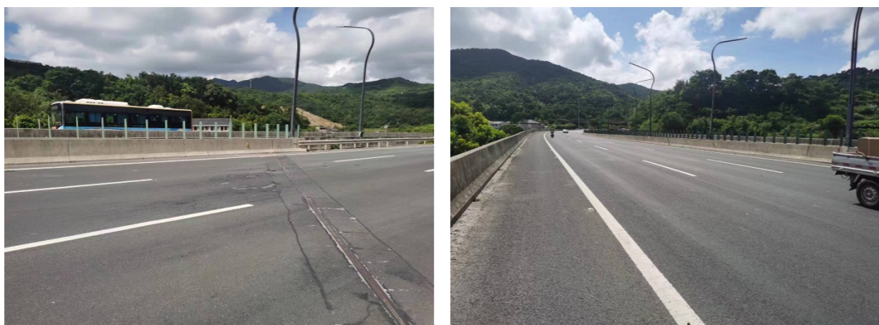
图 33 杜岙大桥路面病害情况
