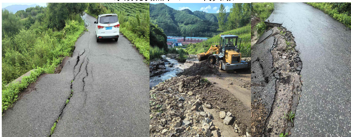
水毁现状照片（Y012 六上路）
