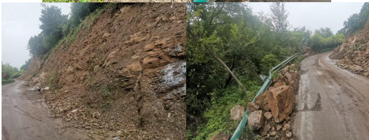
水毁现状照片（C012 干站路）
