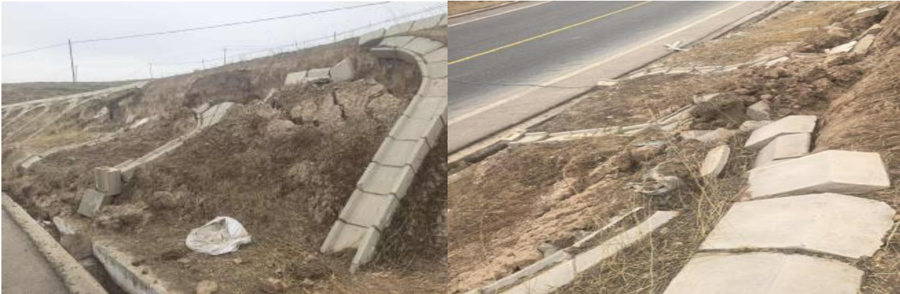
(3) G109 线 K1993+740-K1993+751 处道路右侧（上行线）拱形骨架护坡破损，长度 11m，平均高度 3m。
