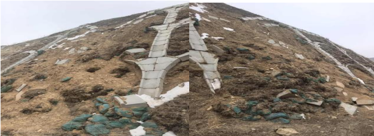
(5) G109 线 K1999+944-K1999+960 处道路右侧（上行线）拱形骨架护坡破损，长度 16m，平均高度 10m。
