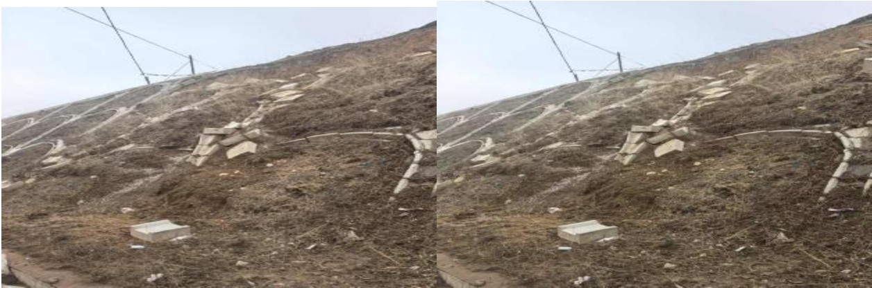
(7) G109 线 K2000+650-K2000+656 处道路右侧（上行线）拱形骨架护坡破损，长度 6m，平均高度 3m。
