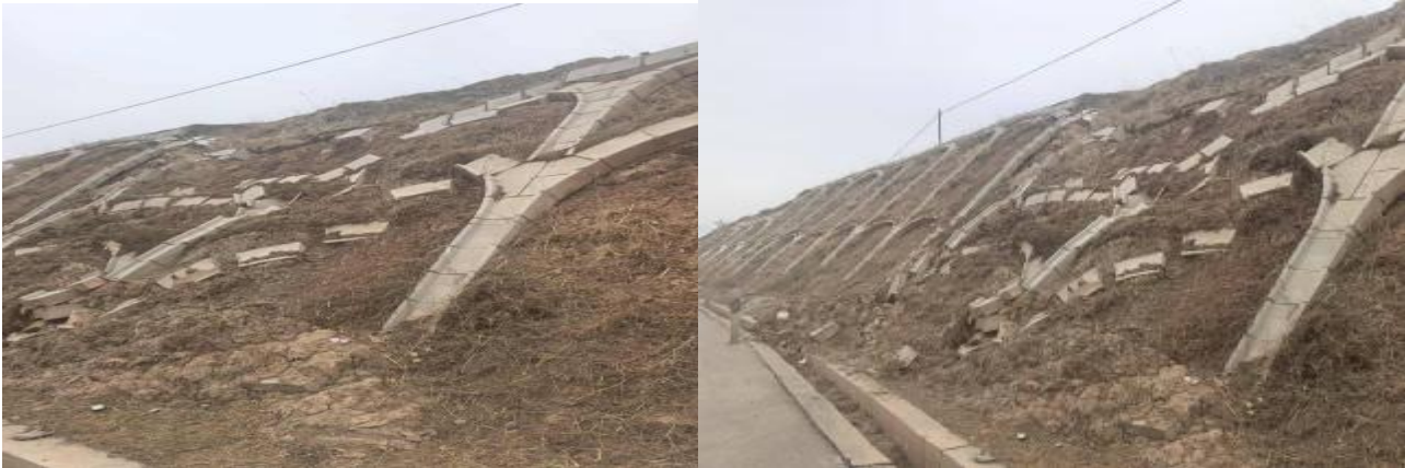
(4) G109 线 K1999+745-K1999+780 处道路右侧（上行线）拱形骨架护坡破损，长度 35m，平均高度 3m。
