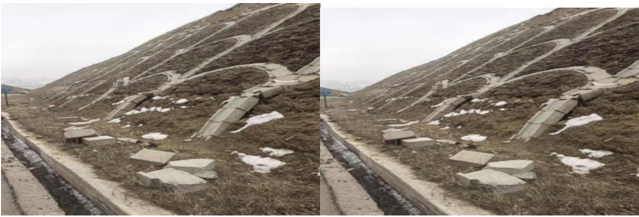
(6) G109 线 K2000+200-K2000+206 处道路右侧（上行线）拱形骨架护坡破损，长度 6m，平均高度 3m。
