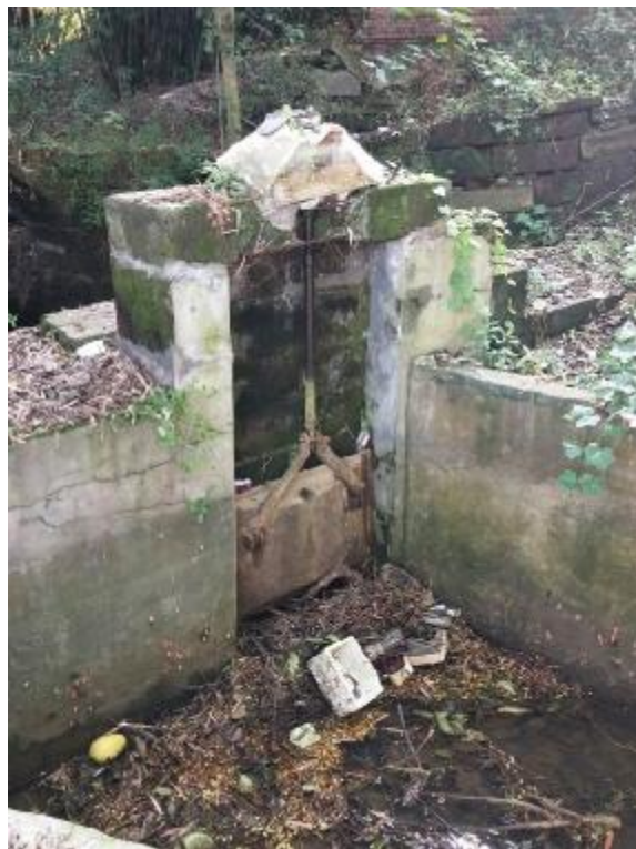
草池支渠 7+587 闸门老旧破损
