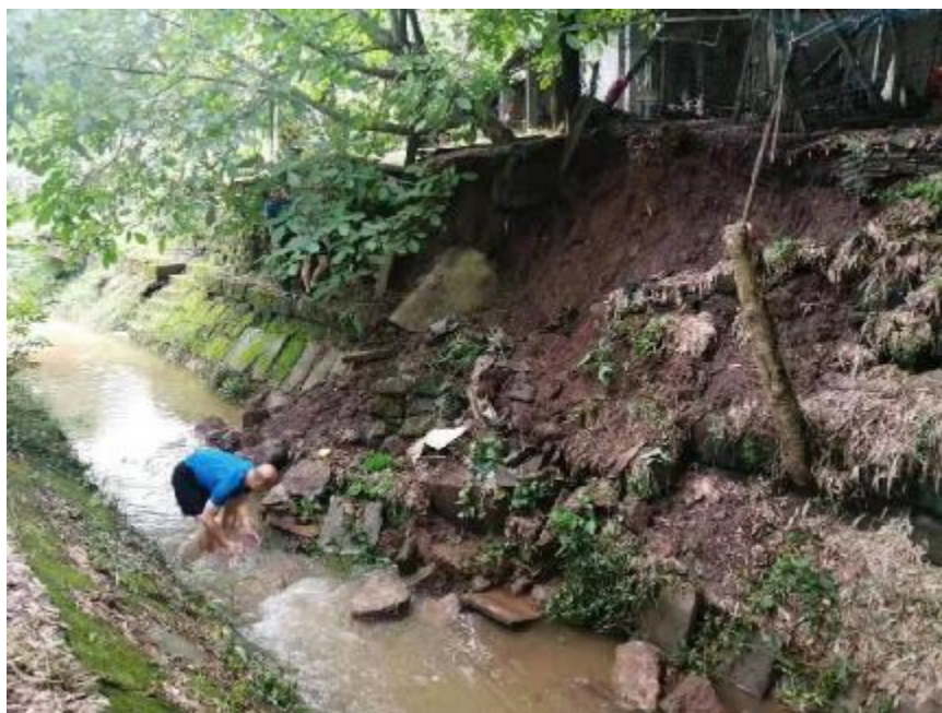
棉丰分干渠 9+300 垮塌淤积
