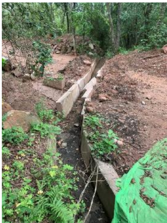
水库排水沟衬砌破坏
