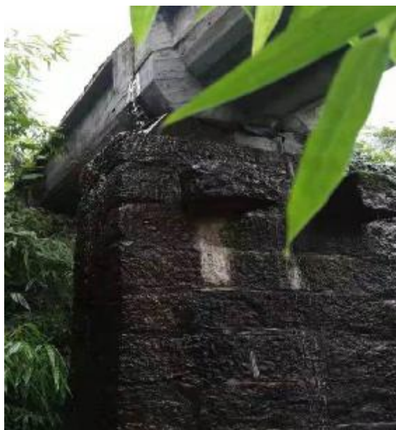
三元支渠渣口岩渡槽渗漏
