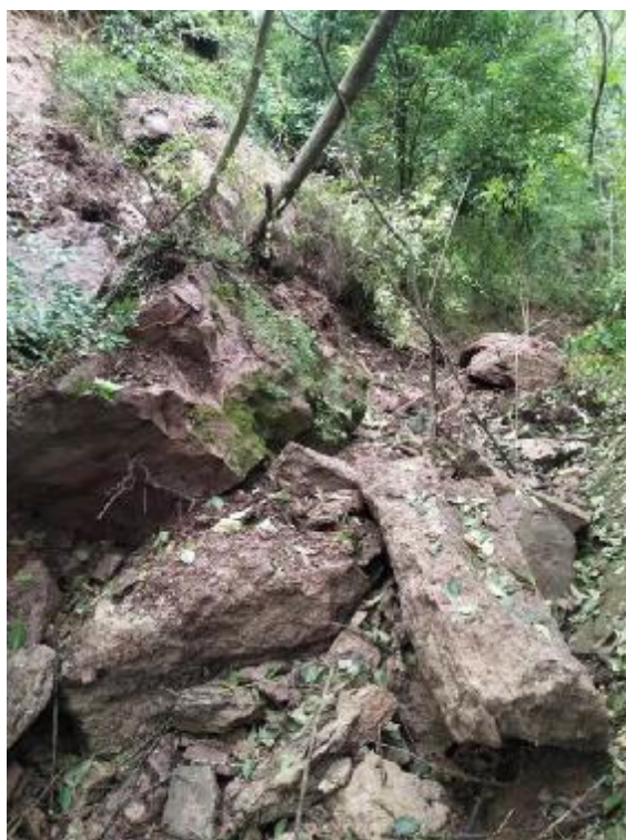
红旗支渠 0+300 垮塌
