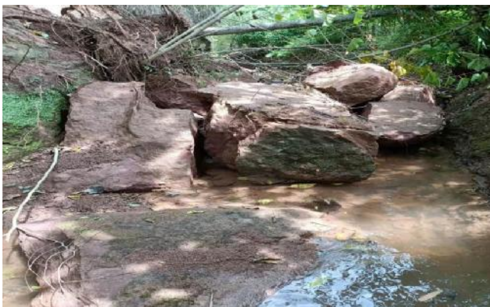
同福支渠 14+985 滑坡淤积
