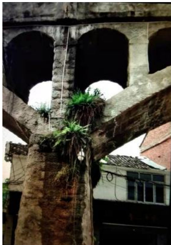
芦葭渡槽 5+700 渗漏
