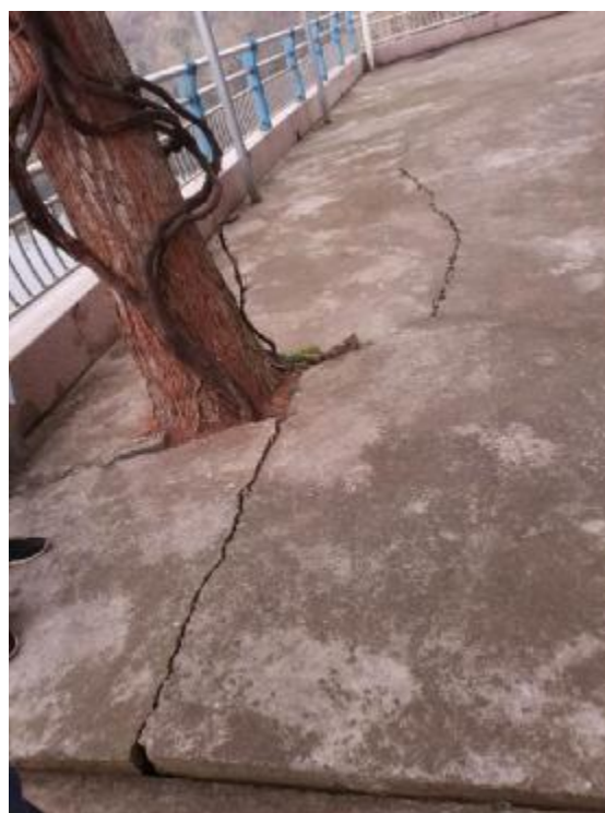
石盘水库大坝后坡马道地面裂缝
