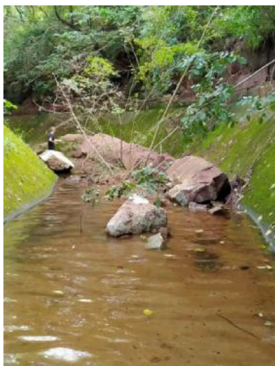
江源干渠 5+200 垮塌淤积
