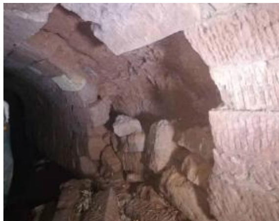
雷一分干渠 11+200 垮塌损坏
