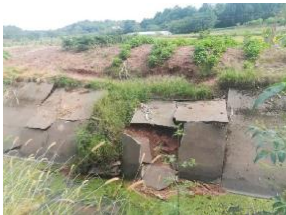
江源干渠 7+300 衬砌边墙垮塌破坏
