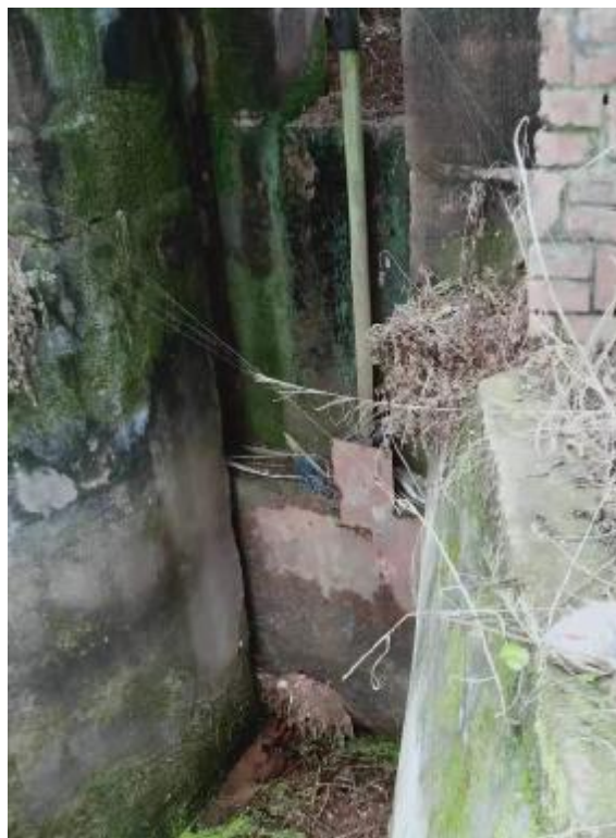
棉丰分干渠 0+000 闸门老旧锈蚀
