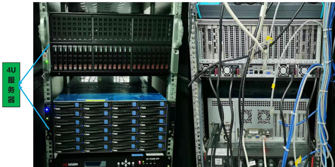
现场设备部署环境正面&背面
