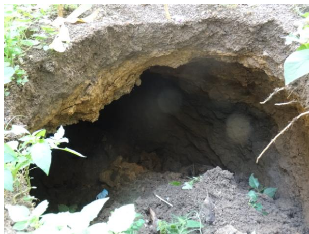
照片 2-4 TX2 塌陷点内景
