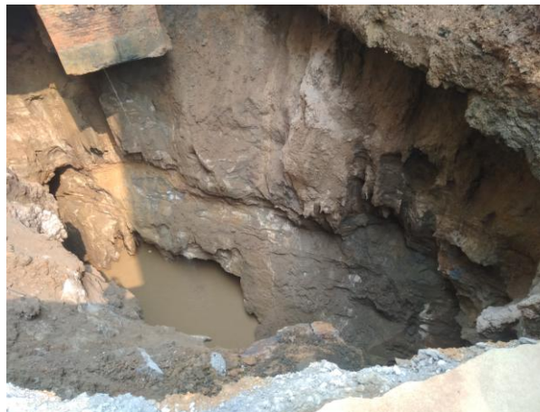
照片 2-2 TX1 塌陷点内景
