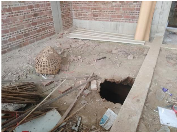
照片 2-9 TX6 塌陷点揭露的坑口
