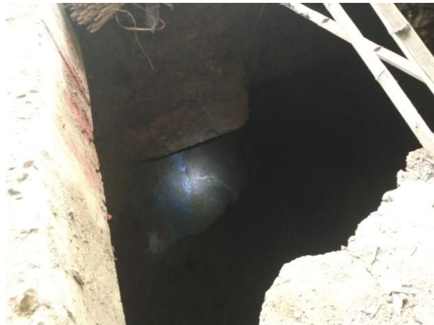
照片 2-10 TX6 塌陷点近景
