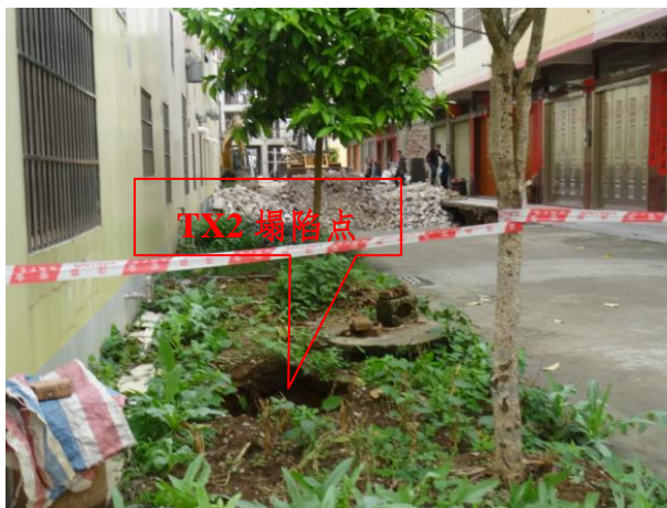
照片 2-3 TX2 塌陷点位置及周边情况照片
