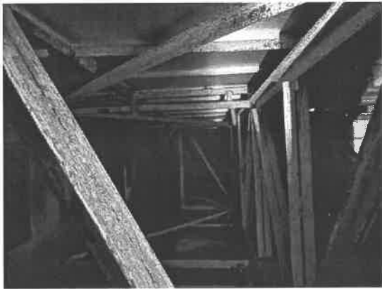
照片9：杆件现状
