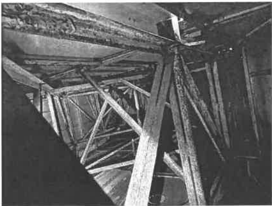
照片7：杆件现状
