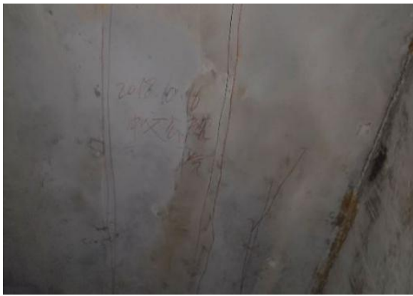
(b) 顶板纵向裂缝
