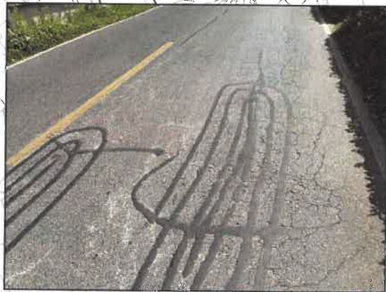
K7+970 沉陷、龟裂
