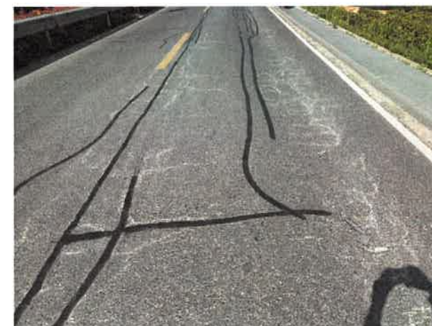
独三线 K8+700 处(龟裂、沉陷、纵向裂缝)
