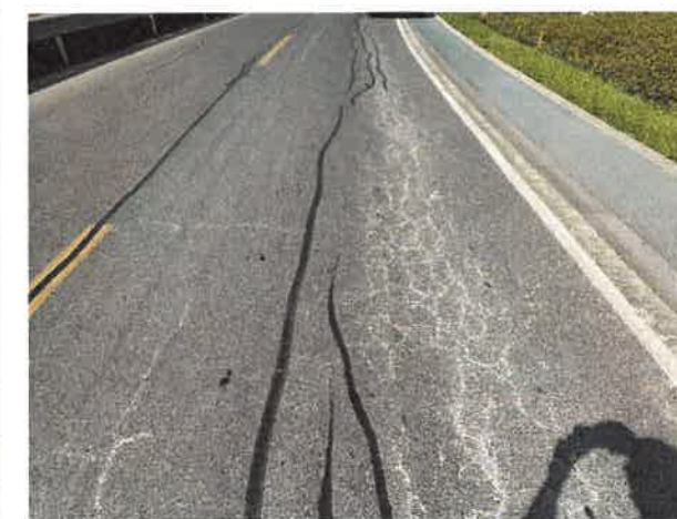
独三线 K8+600 处(龟裂、沉陷、纵向裂缝)
