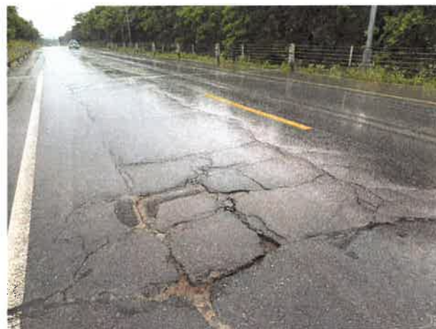
西北线 K12+650 处(坑槽、沉陷、块状裂缝)
