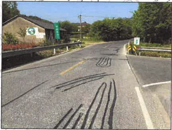
K8+370 沉陷、龟裂
