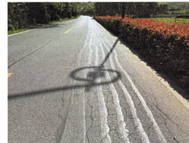
独三线 K9+205 处(龟裂、沉陷、纵向裂缝)
