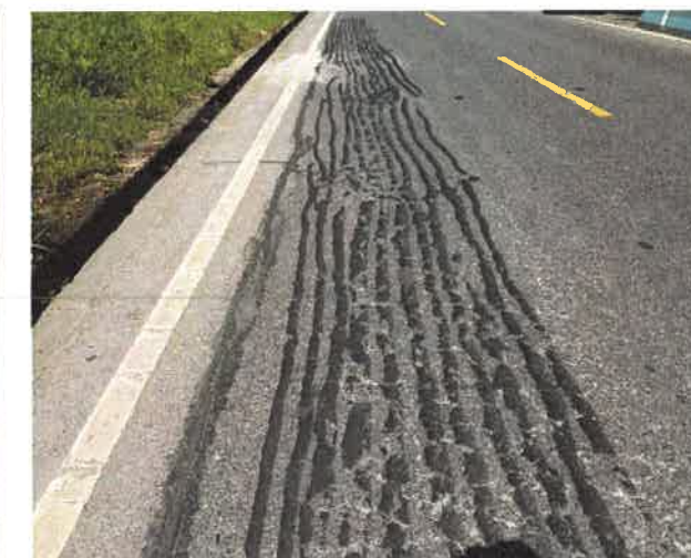
临安线 K97+030 处(龟裂、沉陷、块状裂缝)
