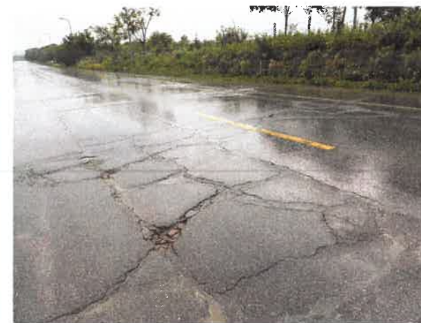
西北线 K13+000 处(坑槽、沉陷、块状裂缝)
