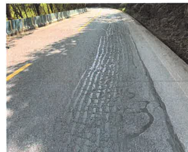
临安线 K96+950 处(龟裂、沉陷、块状裂缝)
