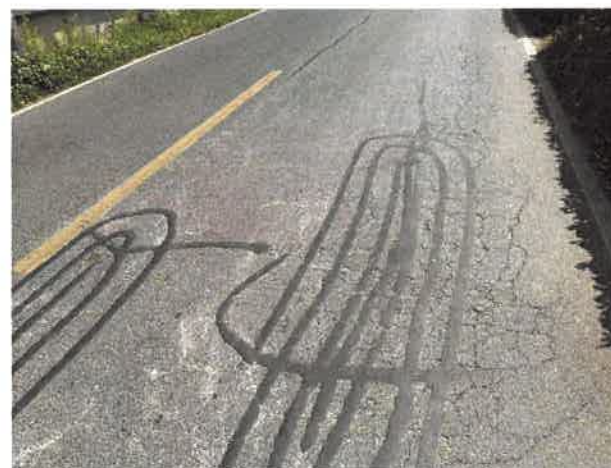
独三线 K7+970 处(龟裂、沉陷)
