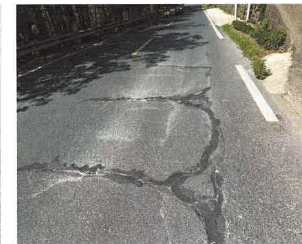
临安线 K101+450 处(龟裂、沉陷、块状裂缝)
