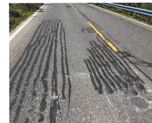
临安线 K97+750 处(龟裂、沉陷、块状裂缝)
