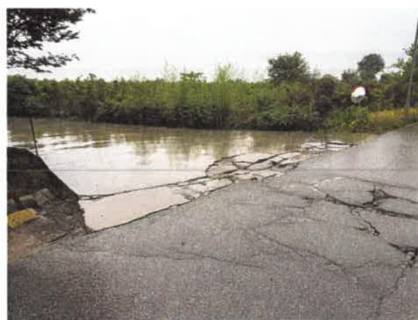
西北线 K12+950 处(坑槽、沉陷、块状裂缝)
