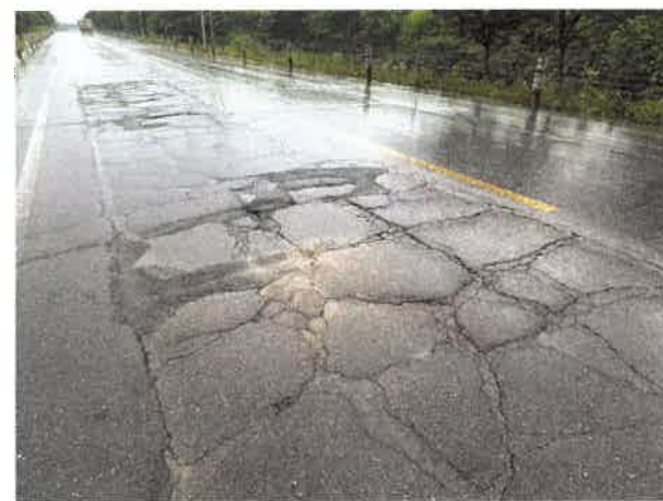
西北线 K12+850 处(坑槽、沉陷、块状裂缝)
