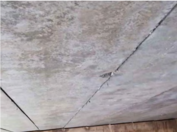
图 1.3-1 2-18#空心板板底破损
