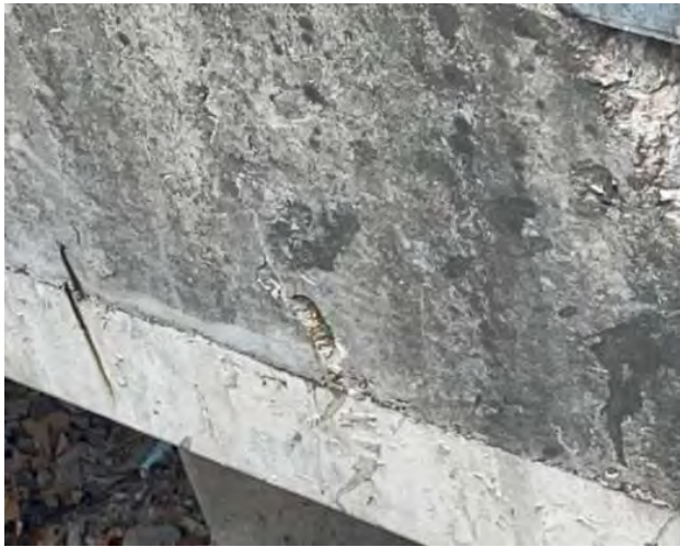
图 1.3-13 1#空心板钢筋锈蚀
