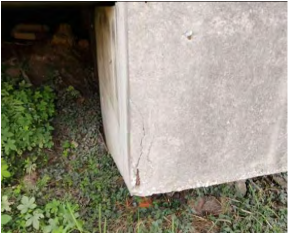
图 1.3-2 2#盖梁左侧面锈胀露筋
