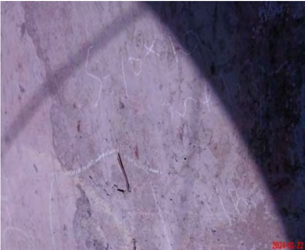
图 1.3-6 6-1#箱梁顶板 剥落
