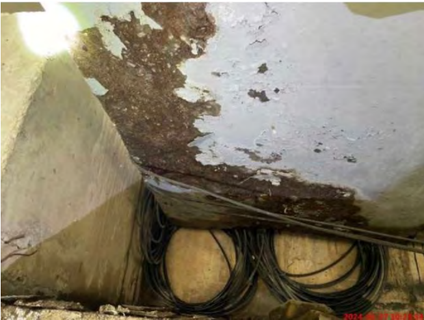
图 1.3-1 1#箱梁底板 麻面
