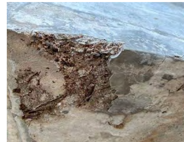
图 1.3-8 2#盖梁左侧面锈胀露筋
