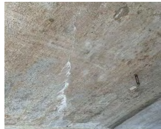
图 1.3-7 2-18#空心板板底破损
