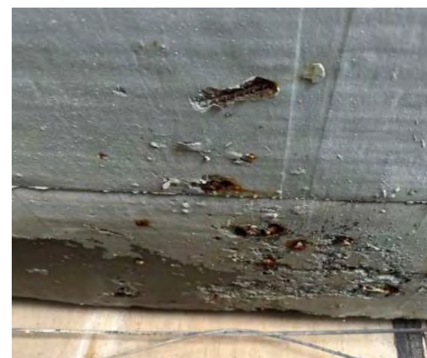
图 1.3-11 1#箱梁底板 露筋
