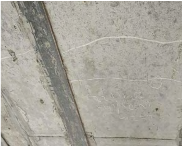
图 1.3-4 5#箱梁底板 纵向裂缝
