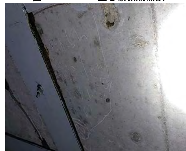
图 1.3-9 5-2#箱梁顶板 纵向裂缝
