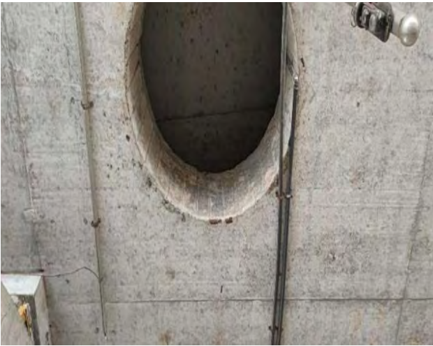
图 1.3-3 5#箱梁底板 露筋
