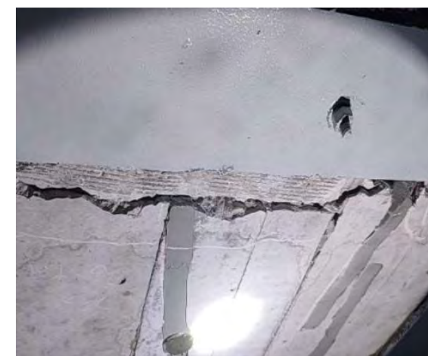
图 1.3-12 6-2#箱梁顶板 剥落
