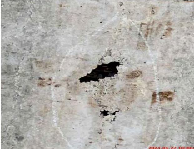
图 1.3-2 2#箱梁底板 空洞
