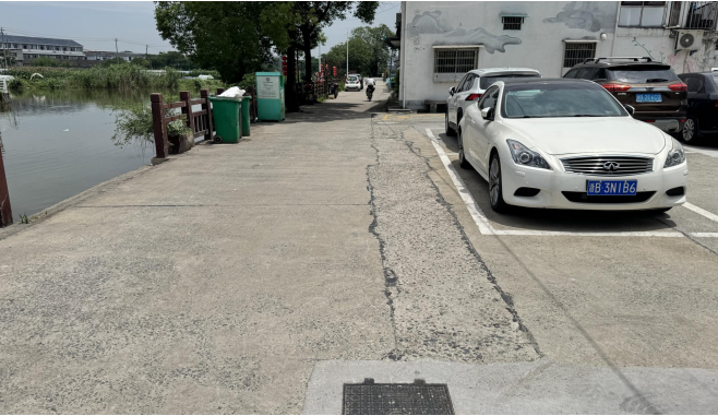
管道开挖修复不良
