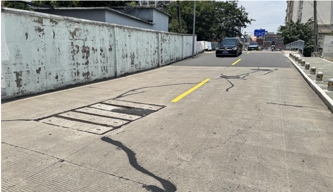
桥头板块破损
