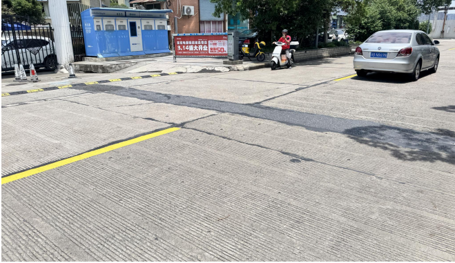
横穿管开挖修复不良
