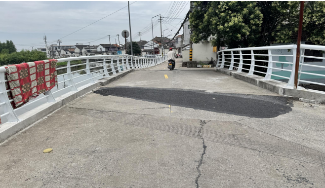
桥头板块破损
