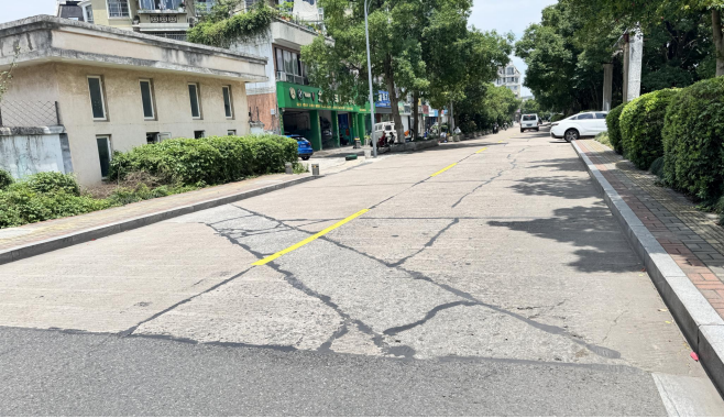
横穿管开挖修复不良
