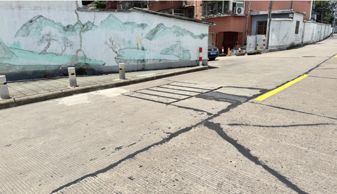
电力井井口板块破损、沉降
