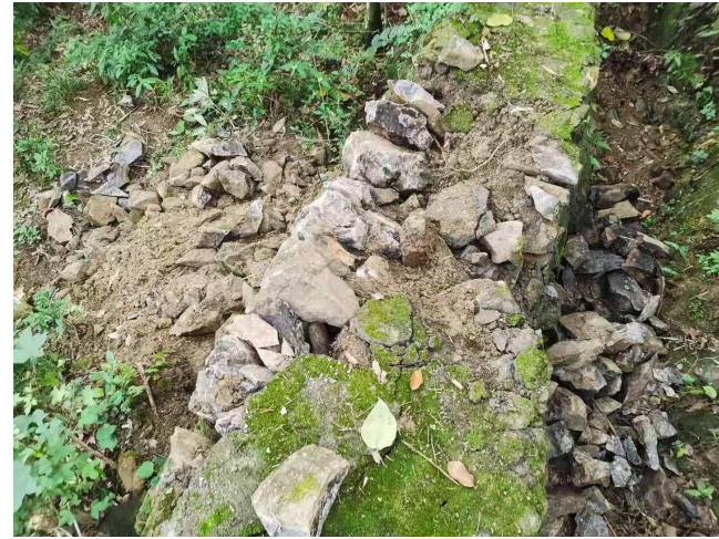
照片2 崩塌体砸毁山坡截水沟
