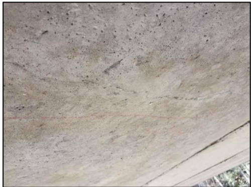
图 1.6-4 3-5#空心板板底横向裂缝
