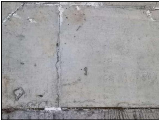
图 1.11-6 1-12#节段箱内斜向裂缝
