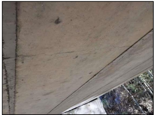
图 1.6-3 3-4#空心板板底横向裂缝
