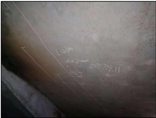
图 1.11-7 2-13#节段箱内纵向裂缝
