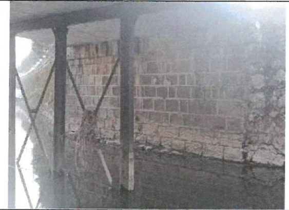
2#桥台台身，前墙，距下缘 0m 处砌缝脱落
