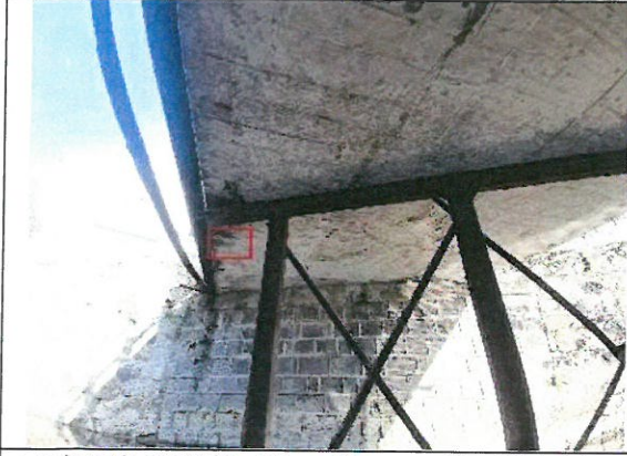
1#跨现浇板板底，距 1#墩 2.5m 处，距右侧 0m 处锈胀露筋
