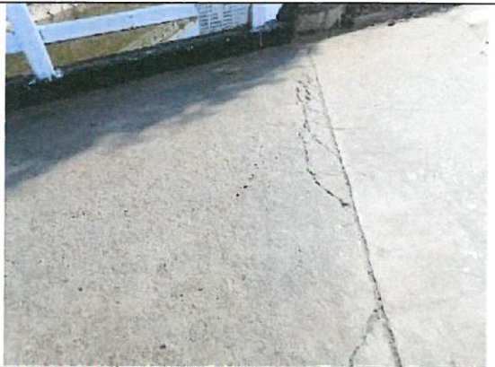
2#跨桥面铺装位于 2#台顶横向裂缝
