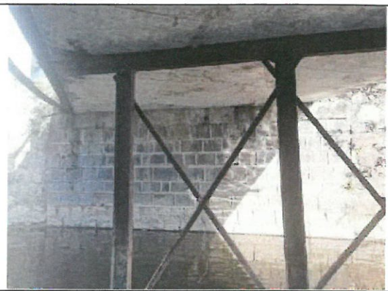
0#桥台台帽渗水
