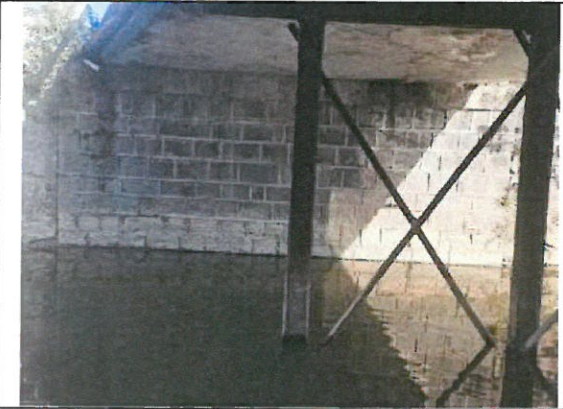
0#桥台台身，前墙，距下缘 0m 处砌缝脱落
