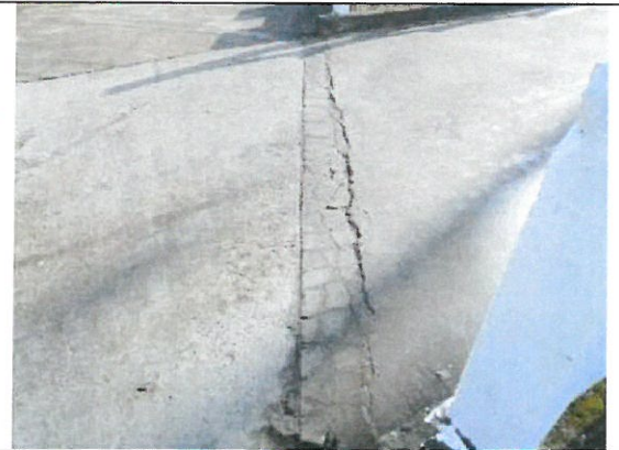
1#跨桥面铺装位于 0#台顶破损
