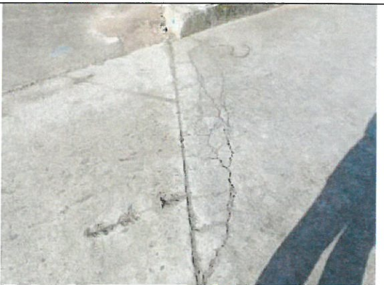
2#跨桥面铺装位于 2#台顶破损
