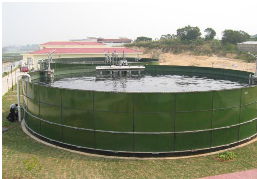
图 3.2-1 河水循环净化处理设备现场照（高度 4m）
