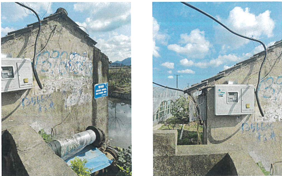
西蔡杨高泵站现状
