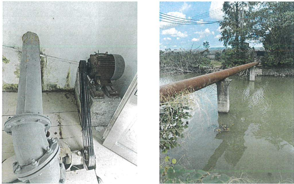
庙前水泵泵站现状
