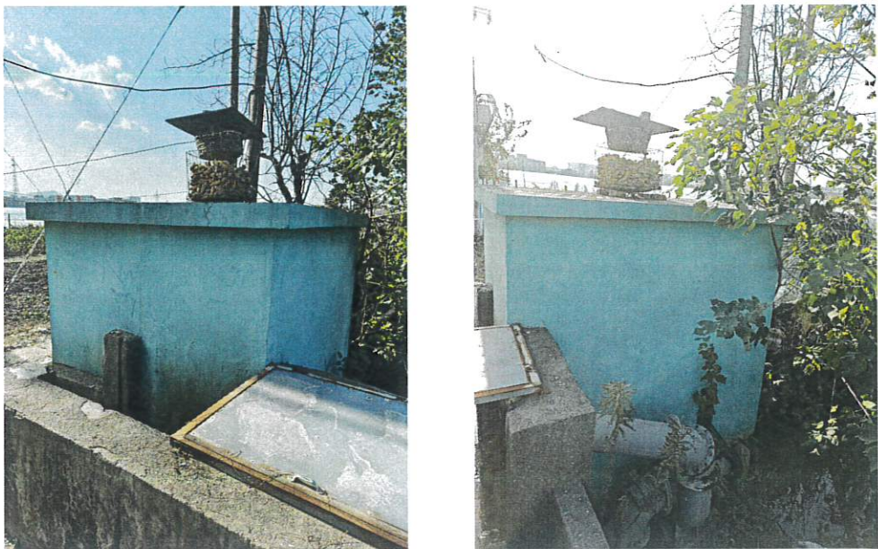
灌溉系数泵站现状
